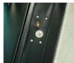
Repères de mise à la terre
